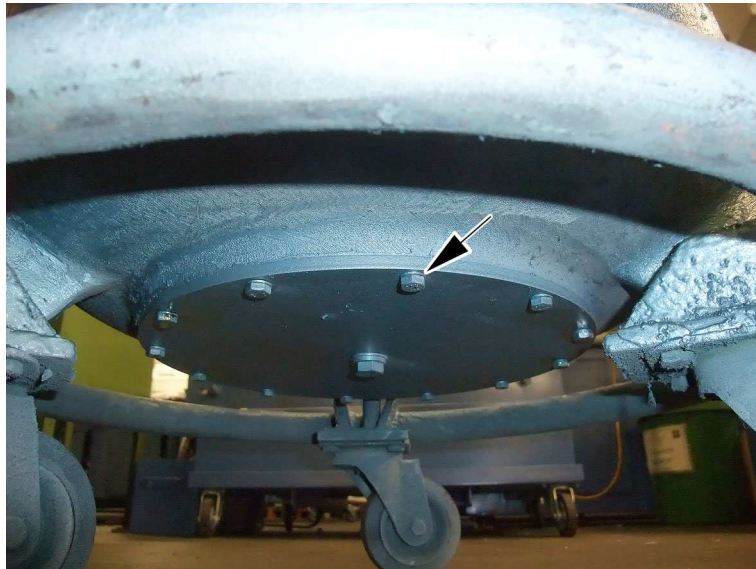
Bild 8.4: Bodendeckel am Aggregat T
